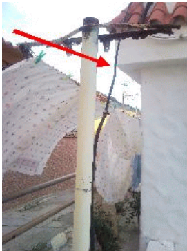
Foto 1.- Cable eléctrico sujeto a un tendedero vecinal.
